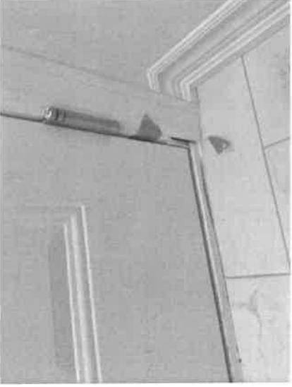
151222 - 1 - TRIM~DAMAGED DOOR JAM RIGHT SIDE OF MAN DOOR
